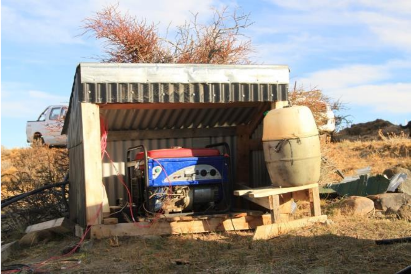
Figura 17-253: Grupo electrógeno, estancia del AISD.
