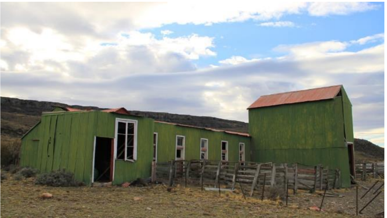
Figura 17-312. Galpones de esquila en mal estado, Ea. La Barrancosa.
